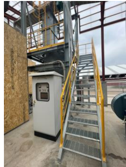
消石灰噴霧装置
