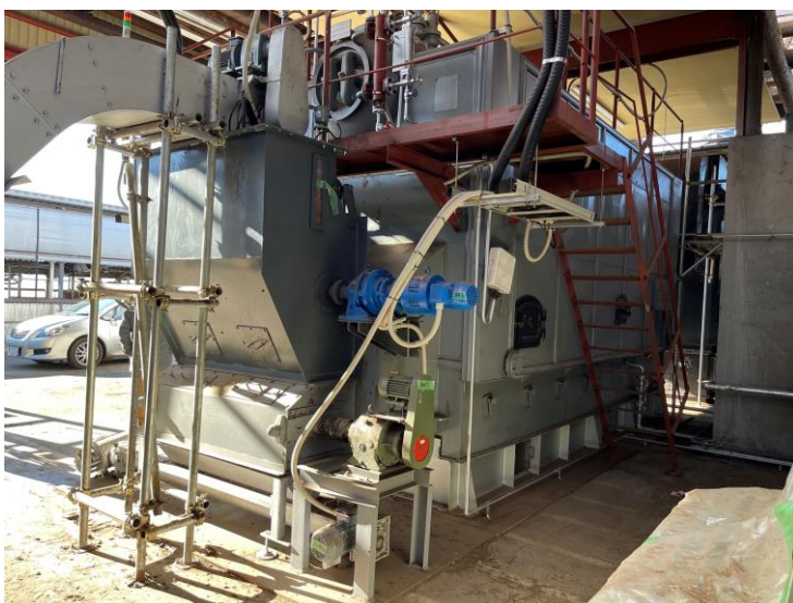
バイオマスボイラ
