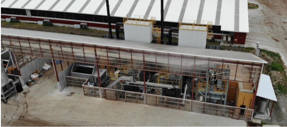
バイオマスボイラ
