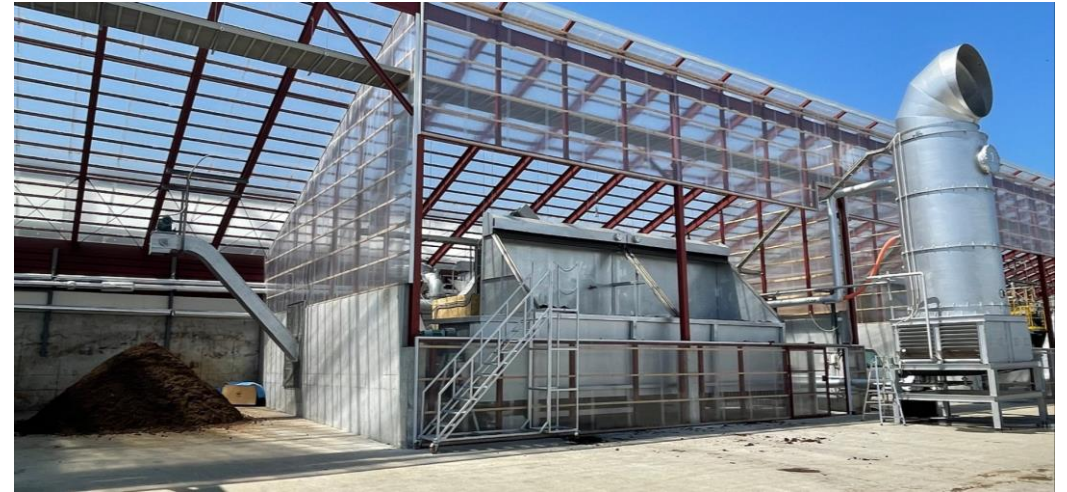
ERS処理装置設置エリア
